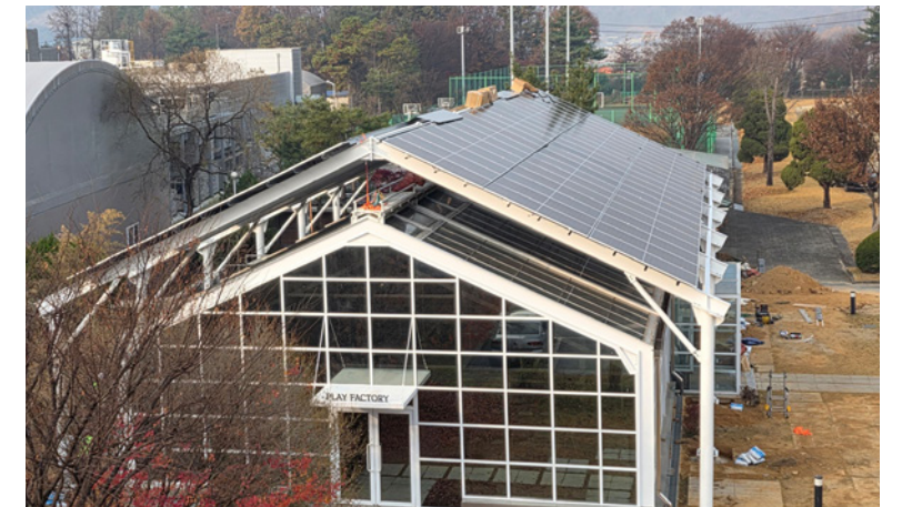
한독캠퍼스 팩토리투어센터 지붕에 설치된 태양광 패널
