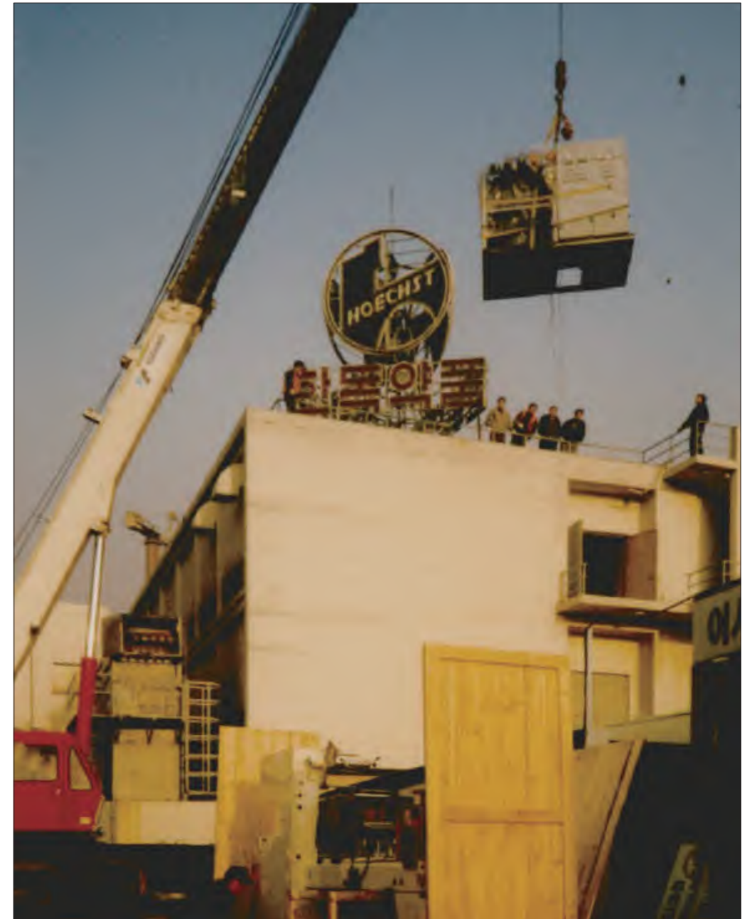
1994년 상봉동 공장 이전 현장. 집기들이 속속 빠지고 있다. 철거가 확정되었기 때문에 대형 기계들은 벽을 부수고 빼냈다.
